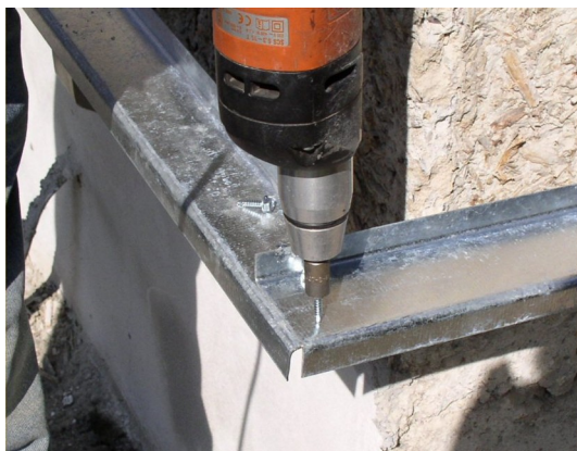
Obr. 9 Nápojení dvou sbíhajících se profilů Z50 na rohu objektu – spojení prvků dvěma šrouby.
